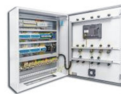
Автоматика теплового пункта
