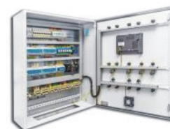
Автоматика теплового пункта
