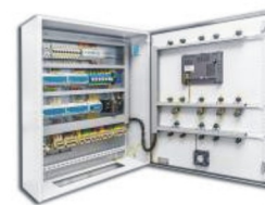
Автоматика теплового пункта
