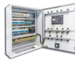
Автоматика теплового пункта
