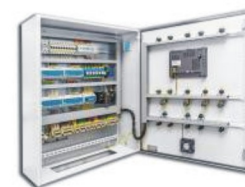
Автоматика теплового пункта
