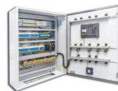
Автоматика теплового пункта
